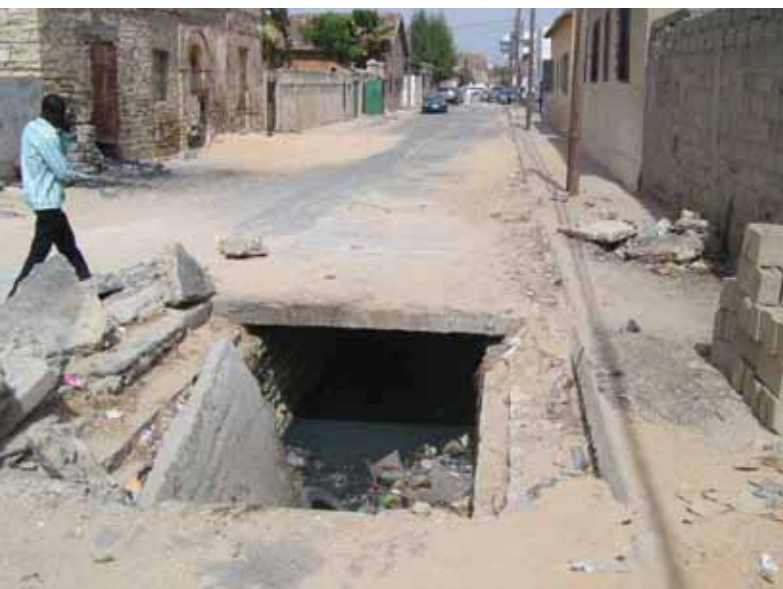
Photo 27. Système d'assainissement pluvial vétuste, mal entretenu et drainant les eaux usées à Rufisque
