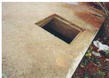
Fotografia 2.41 – Detalhe da falta da tampa da fossa séptica do bairro de Nossa Senhora da Saúde
