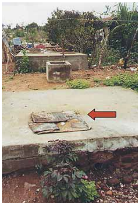
Fotografia 2.40 – Fossa séptica e filtro anaeróbio com cobertura de papelão
