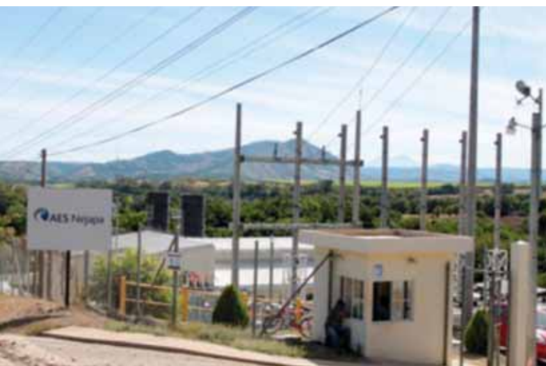
Foto 4. Subestación AES Nejapa, en el relleno sanitario de MIDES. Fuente: Marielos Marín, 2012.
