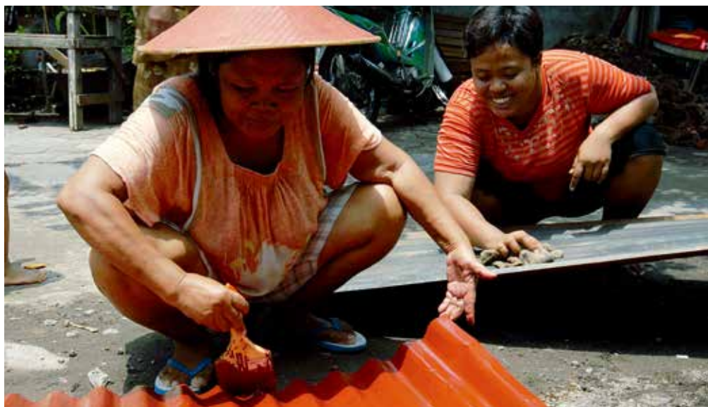
图35：在印度尼西亚梭罗市（Solo），妇女正在为整修房屋准备屋面材料。
