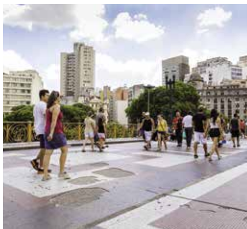
El viaducto de Santa Ifigenia en São Paulo, Brasil, dañado por falta de mantenimiento © Frazao Productions/Shutterstock.com
